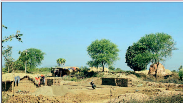
जिम्मेदार अधिकारियों की निष्क्रियता और इस मुद्दे पर उचित कार्रवाई न होने से नागरिकों के बीच असंतोष फैल रहा है। नागरिकों का यह भी कहना है कि प्रशासन का इस मामले में मौन रहना और उचित कार्रवाई न करना यह दर्शाता है कि अवैध ईट निर्माण के कारोबार को लेकर प्रशासन की मंशा संदिग्ध है।
